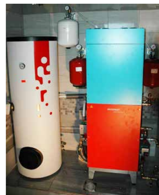
Obrázok 60 Kompaktná vetracia jednotka aerosmart X2 s tepelným čerpadlo zem/voda s výkonom 3,6 kW a 300 l zásobník na teplú vodu v pasívnom dome. (IEPD)
